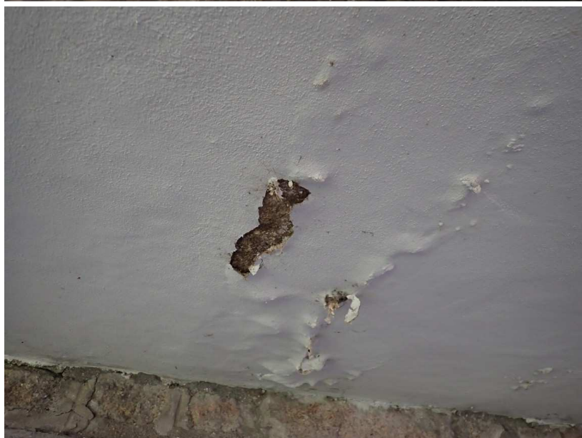
Detail poškozené sanace v podhledu NK u levé opěry
