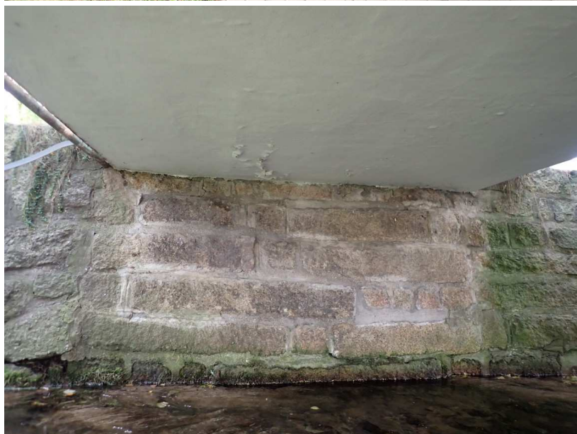
Podhled NK s poškozenou sanací
