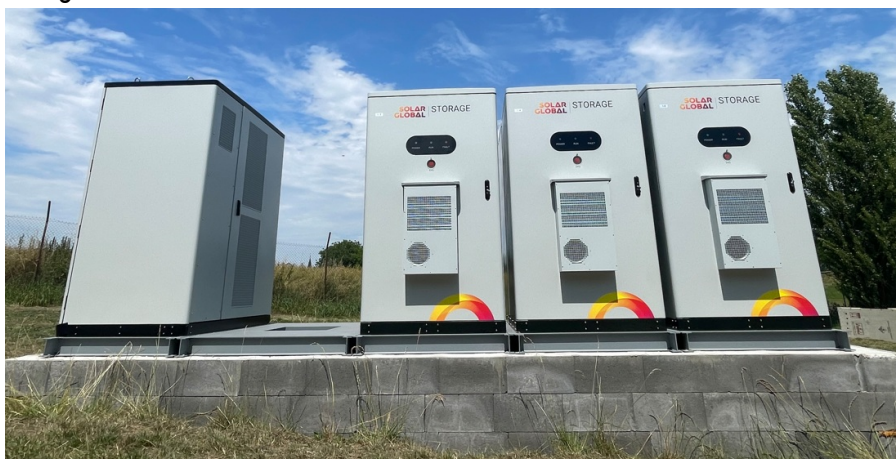
Fotografie bateriového úložiště BESS 500 kW
