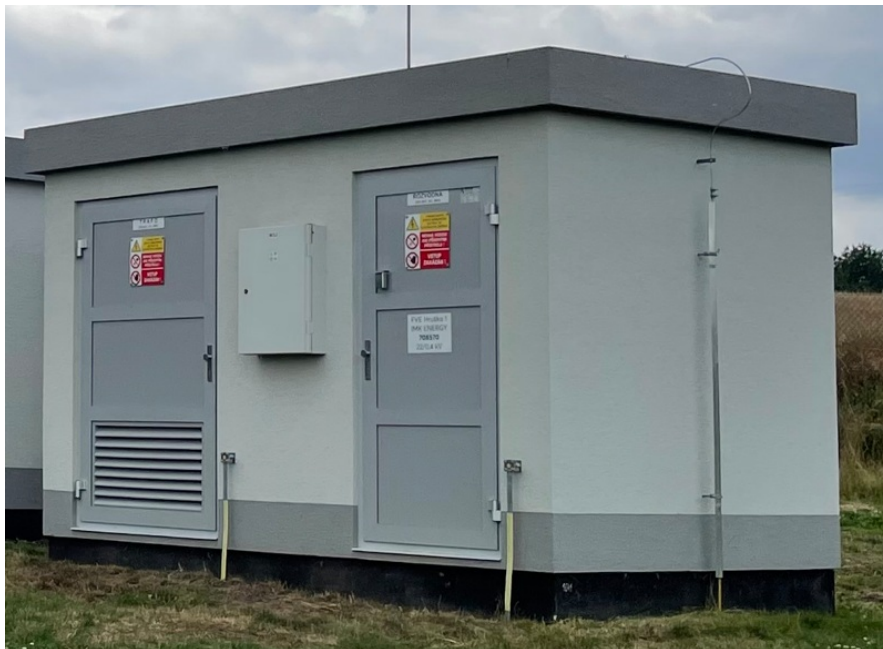
Fotografie trafostanice TS01
