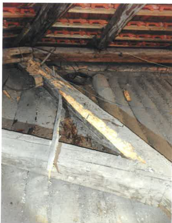
Napadení trámů Tesaříkem Krovovým (nutná výměna)
