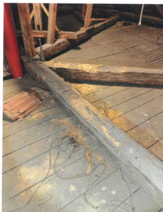
Napadení trámů Tesaříkem Krovovým
