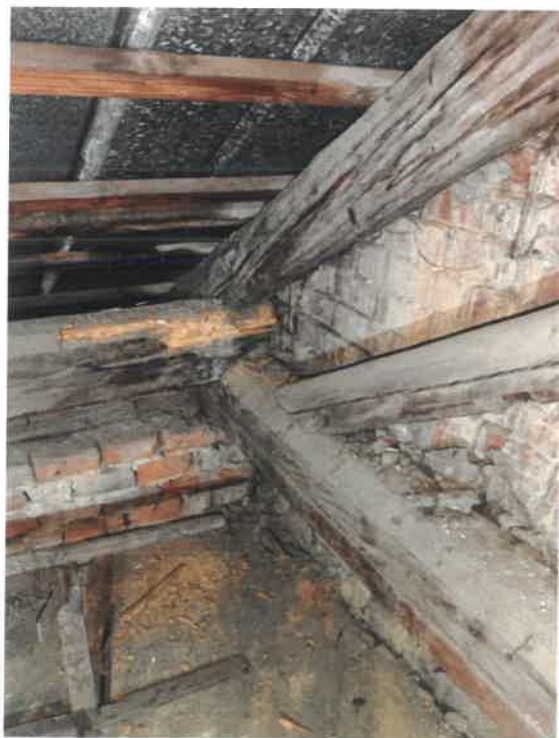
Napadení trámů Tesaříkem Krovovým
