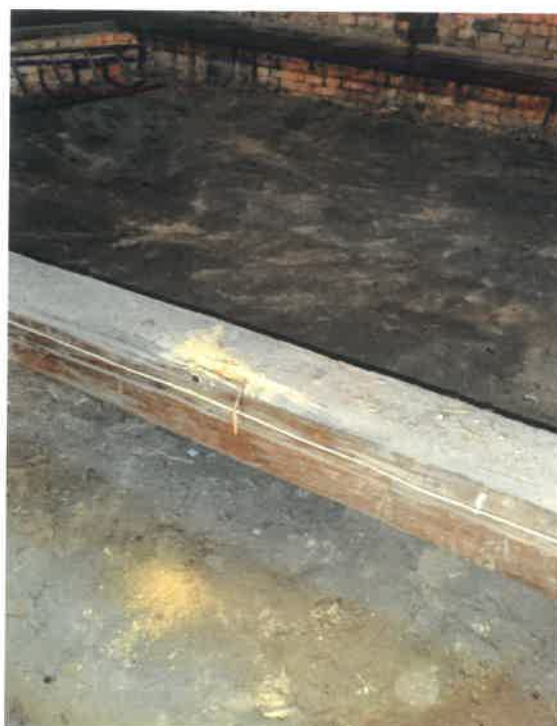
Napadení trámů Tesaříkem Krovovým
