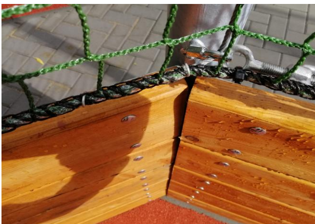
Chybně provedené napojení mantinelu v šikmém rohu
