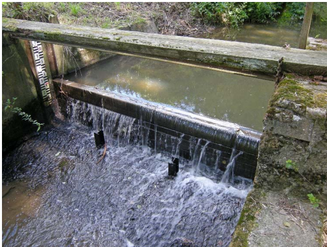
Obr.1 – Pohled na prosakující hradící konstrukci – stávající stav
