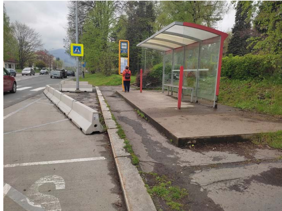
nevyhovující bariérový přístup na zastávku
