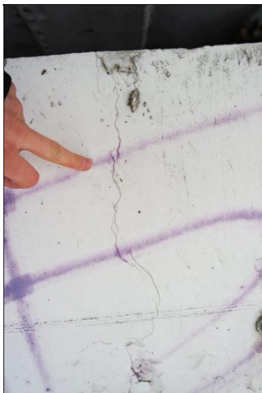
Svislé trhliny v lici opěry 01 do šířky cca 0.25 mm.
