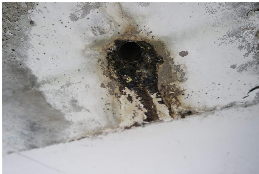
Stopy po zatékání do komory mezi krajními nosníky.
