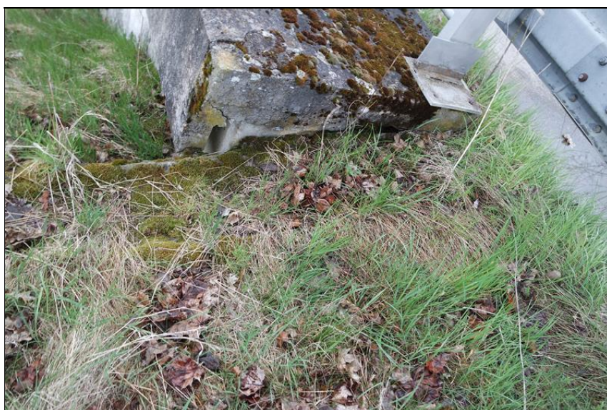
Skluz odvodnění - typický stav.
