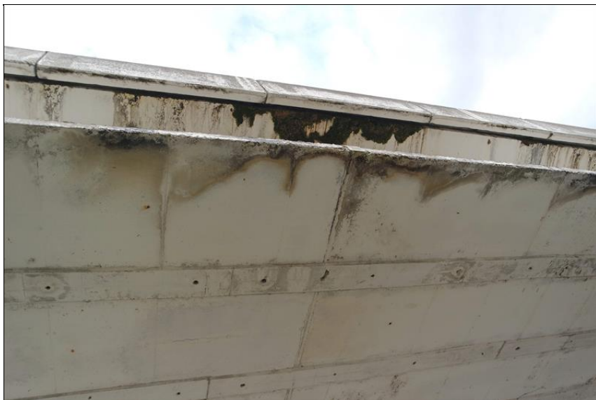
Stopy po zatékání na podhled nosné konstrukce z boku.
