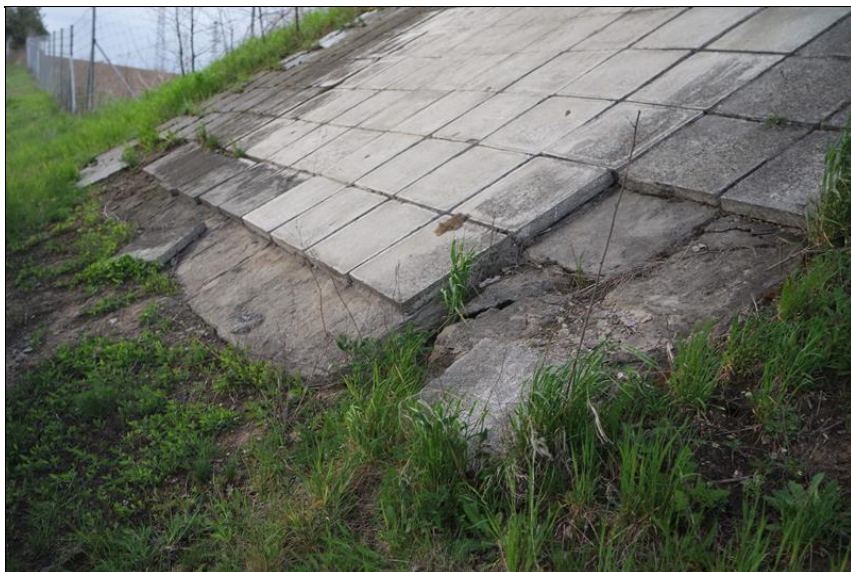
Separace betonových dlažeb před opěrou 03 - chybějící dlaždice.
