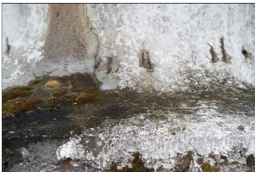
Inkrustace a menší poruchy krycí vrstvy na bocích nosné konstrukce.
