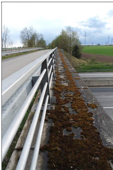
Stav římsy na mostě.
