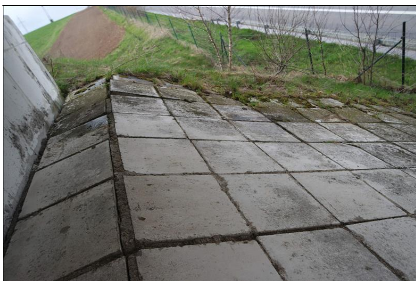
Separace betonových dlažeb před opěrou 01 - deformace dlažeb.
