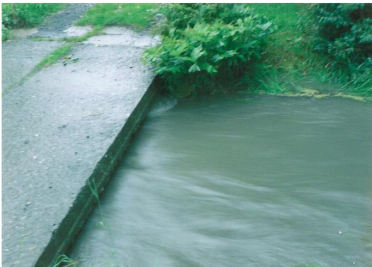
Obrázek 35: Rozvodněný Týnecký potok u lávky L5, ulice K Potoku
