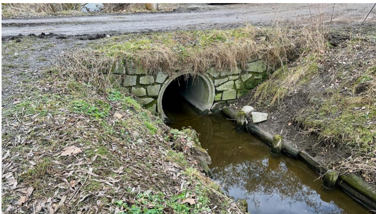
Obrázek 12: Zatrubnění Z1, Brandýsek
