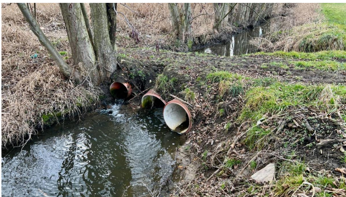
Obrázek 20: Zatrubnění Z2, Brandýsek
