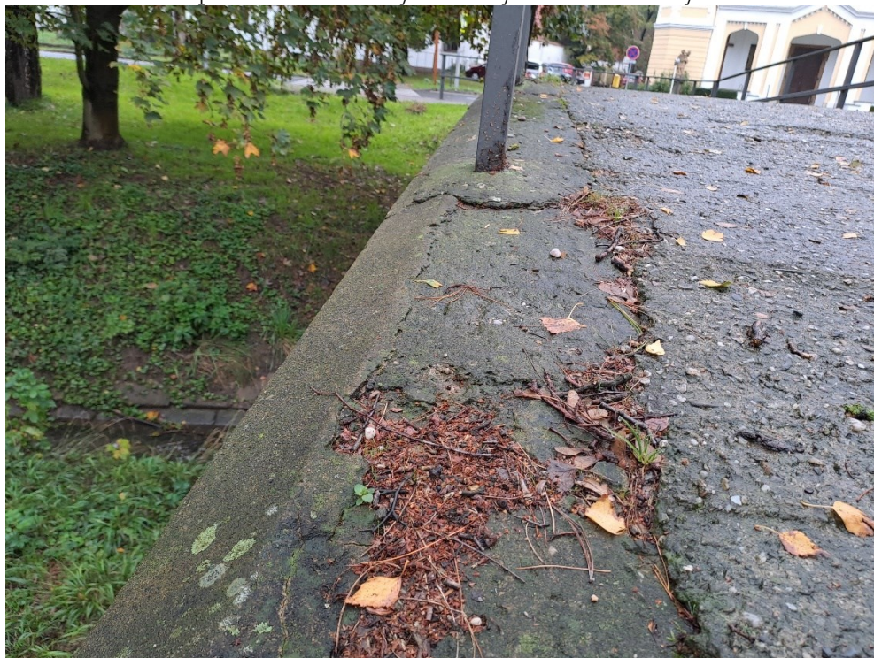
Pohled na horní povrch levé římsy – trhliny v betonu římsy
