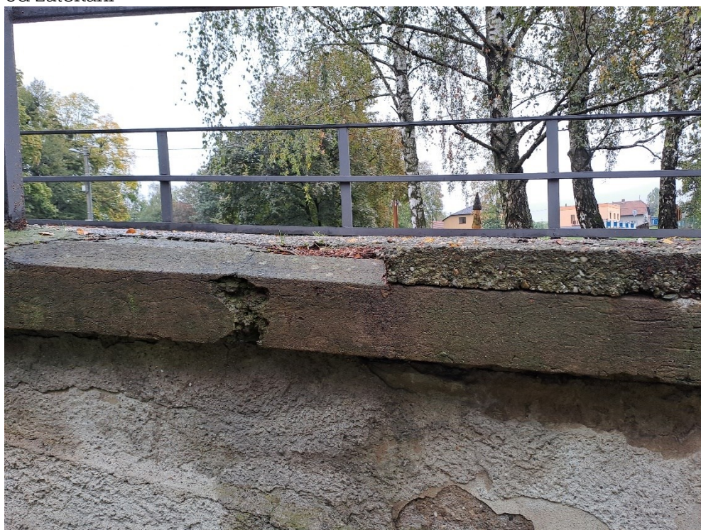
Pohled líc levé římsy u OP1 - degradace betonu do hl. až 100mm, beton nadbetonování římsy má porézní povrch, ve vodorovné spáře mezi římsou nadbetonováním jsou stopy od zatékání
