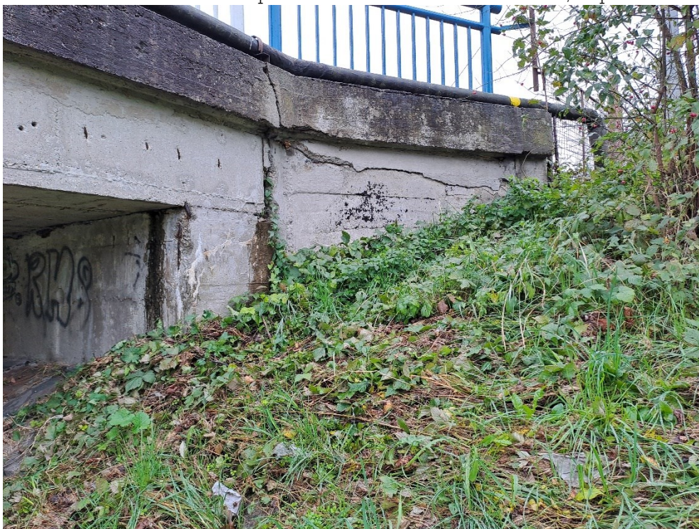
Pohled na levé křídlo OP1 – podélná trhлина v celé délce křídla, odpadávání omítek.
