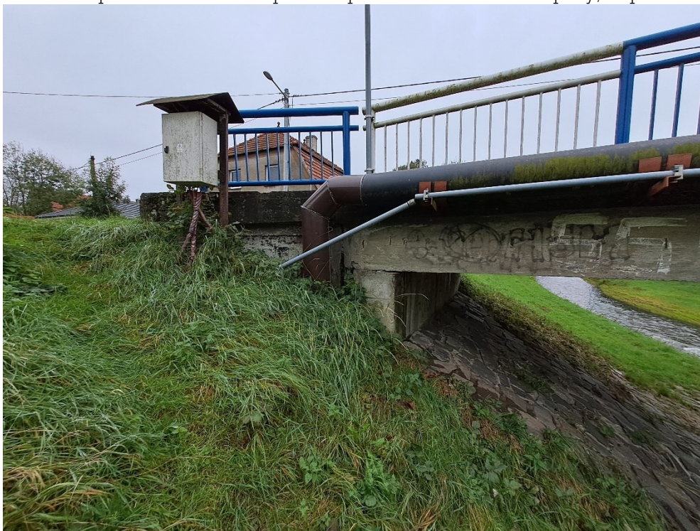
Pohled na pravé křídlo OP1 – porézní povrch betonu křídla opěry, odpadávání omítek
