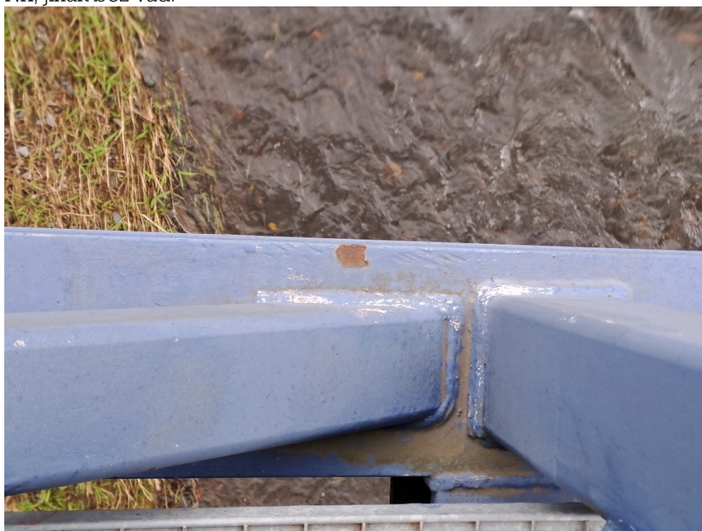
Pohled na dolní pás příhradového nosníku NK – lokálně poškozená protikoroze ochrana NK, jinak bez vad.
