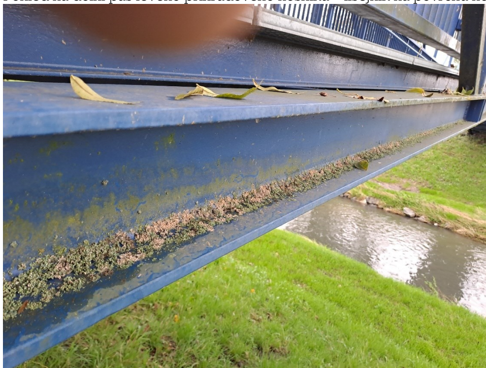
Pohled na dolní pás levého příhradového nosníku – lišejník na povrchu nosníku
